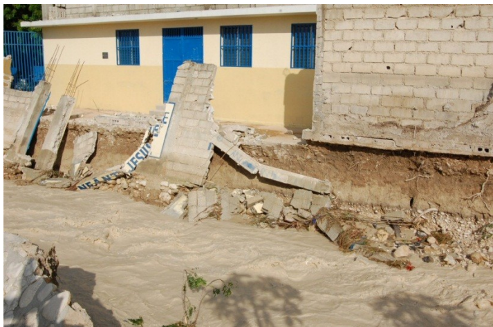
Route inondée, mur d'enceinte détruit à Lamardelle
